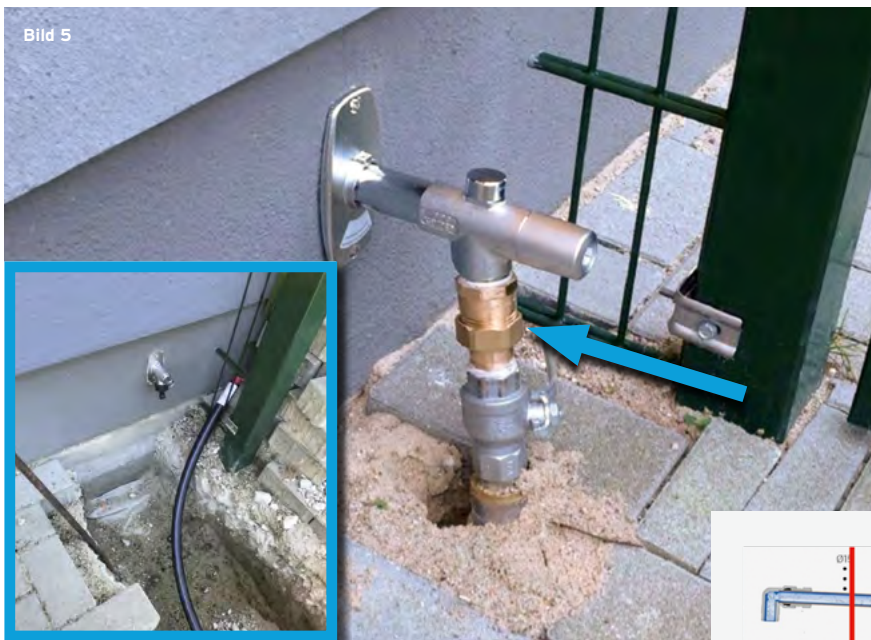
Bild 5 / Die Rohrleitung zur „Matschanlage“ im Erdreich ist dauerhaft fest mit dem Außenwasserhahn verbunden (Pfeil). Dadurch kann der Außenwasserhahn auch im abgesperrten Zustand nicht mehr leerlaufen und die „frostsichere“ Eigenschaft ist nicht mehr gegeben.
